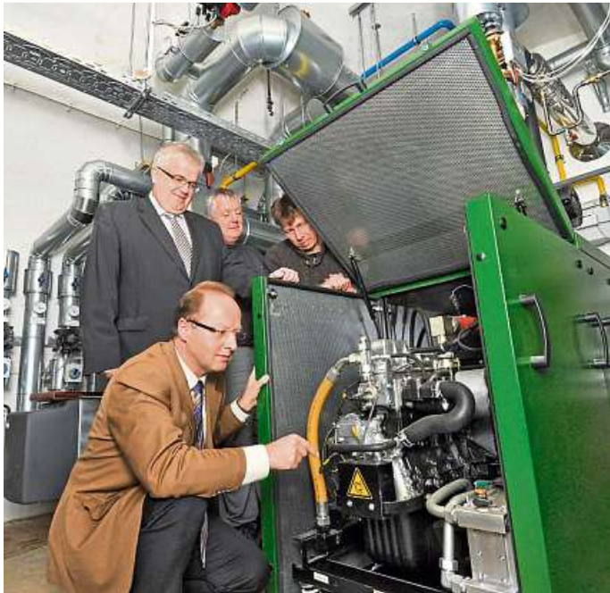
Das Blockheizkraftwerk der Grundschule Sprendlingen zählt mit zu den Vorzeigeprojekten der VG Sprendlingen-Gensingen. Archivfoto: Schmidt
